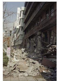
日本ビル(崩壊)
